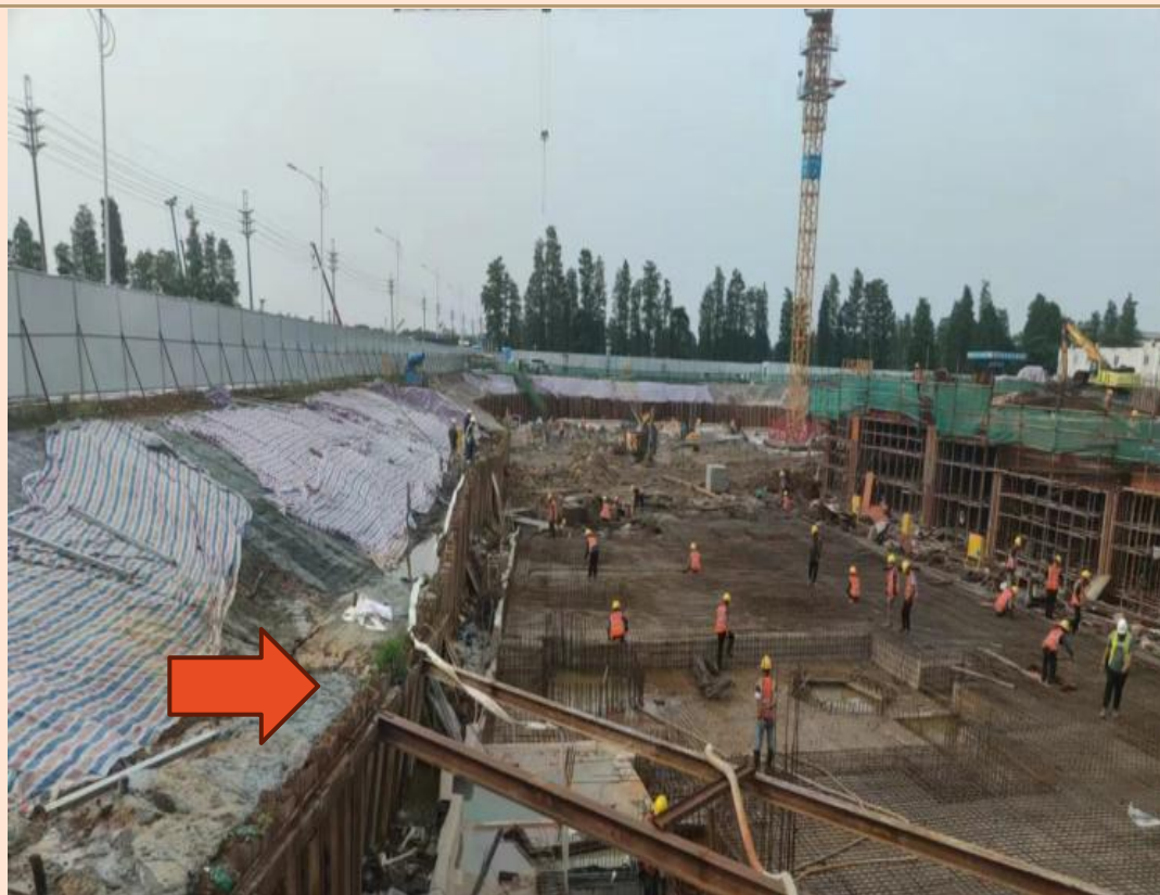
钢板桩变形，有渗漏点出现。
