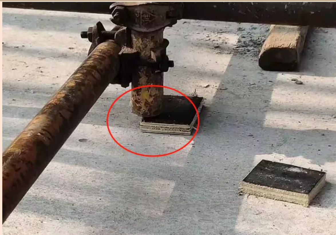
落地钢管操作层部分立杆悬空
