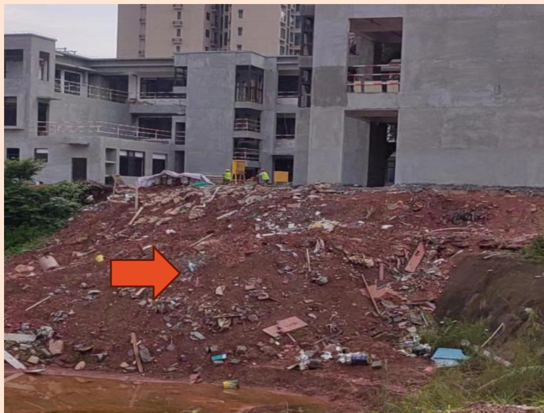
基坑边坡土体松散。
