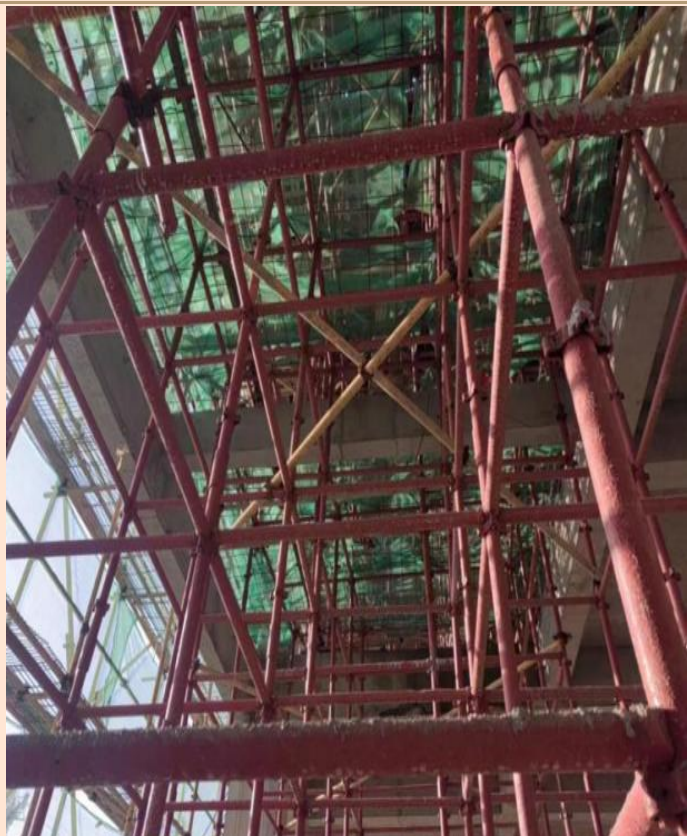
电梯井架未编制施工专项方案。
