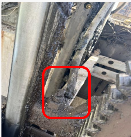
导轨架节斜腹杆端部脱焊
