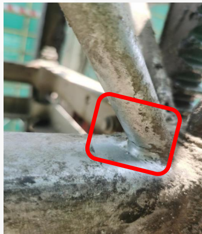
导轨架节斜腹杆端部焊缝裂纹
