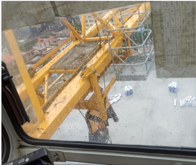
起升高度限位器失效
