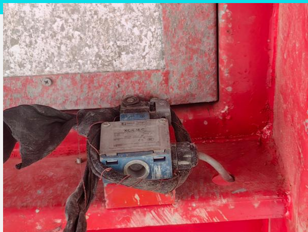
紧急出口电气限位人为绑扎，功能失效
