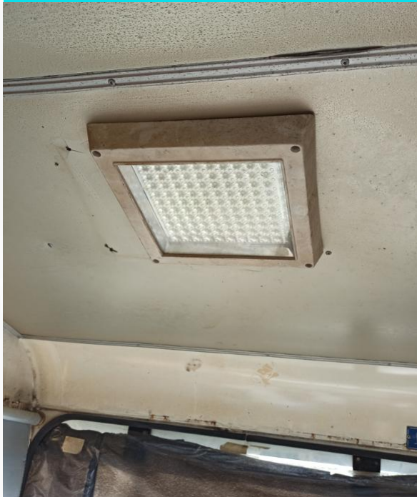
司机室内照明失效
