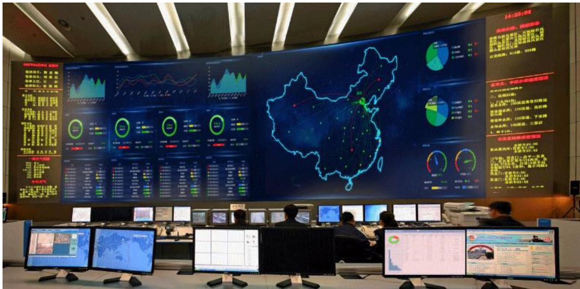
城市运维系统
