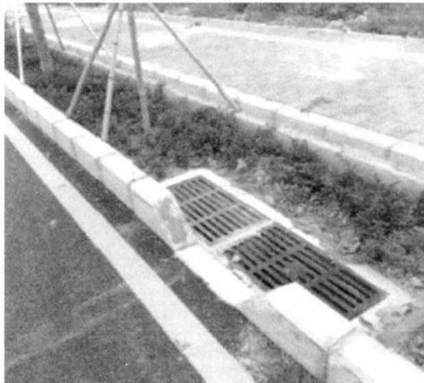
立道牙开口正对植草沟溢流口（不合理）
