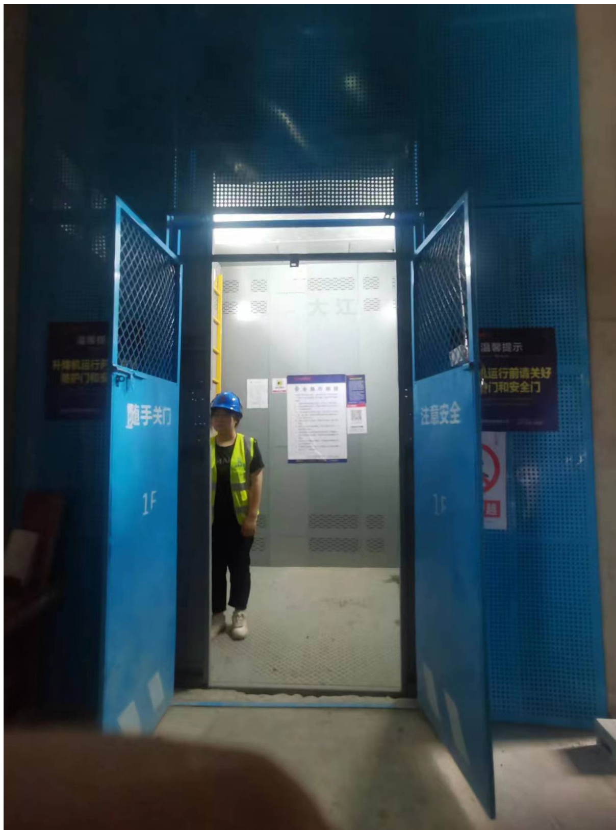
施工升降机进出门
