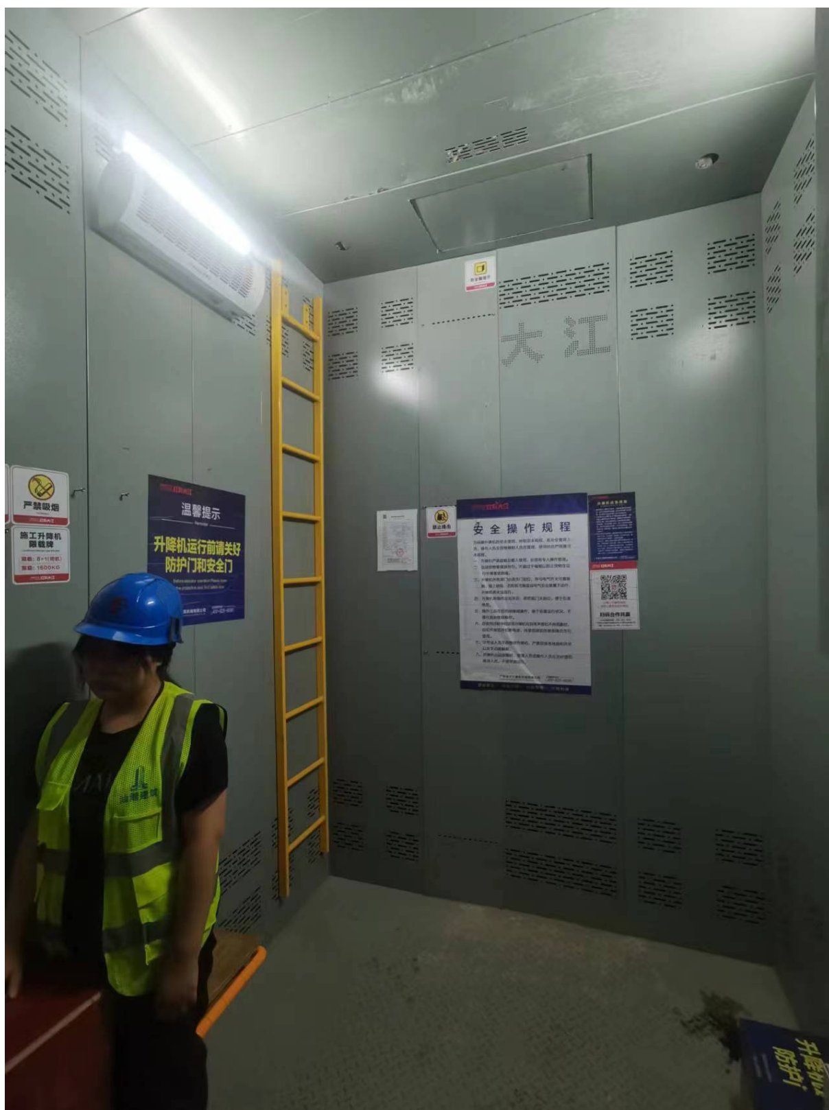
施工升降机内部图片
